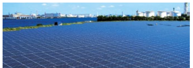
↑太陽光発電装置が多数並ぶ、扇島太陽光発電所。
